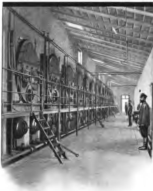
Паровые котлы на перегонномъ заводѣ Т-ва.
