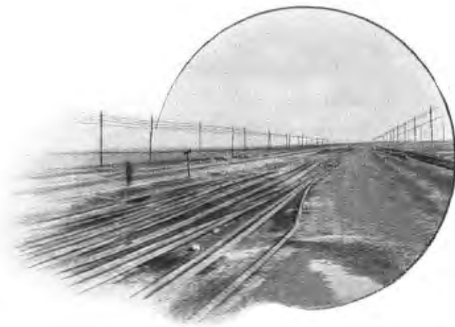
Общій видъ нефтепроводовъ.
