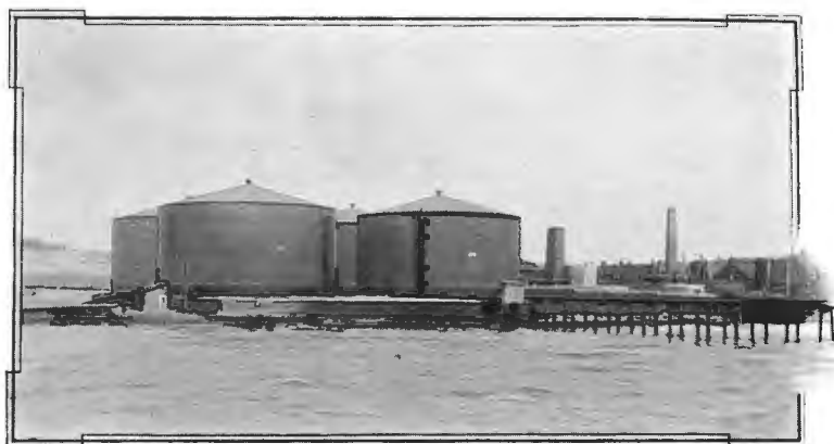
Резервуары для мазута.
